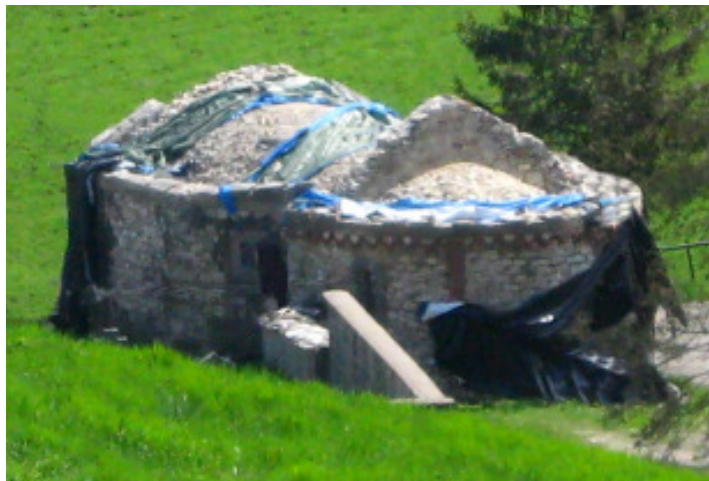
Il tetto dell'oratorio devastato dal vento
